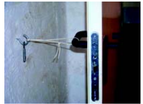
Diese Feuerschutztür kann bei einem Brand nicht ihre Aufgabe erfüllen, tödliche Brandgase zu stoppen.
