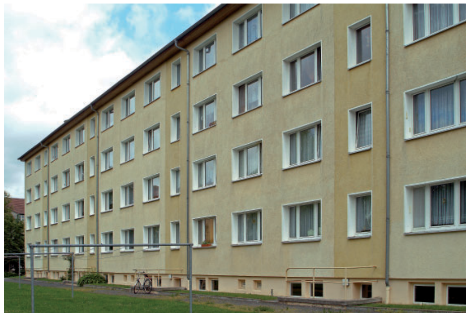
Die Fassade der Leonhard-Frank-Straße 10–13 wird sich gründlich ändern; vorerst werden an den Eingängen 12 und 13 Balkone angebracht.
